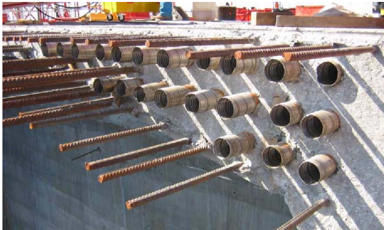
Figura 3.32. Ductos vacíos en la cartela superior.
