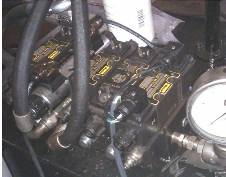
Figura 82. Bloque de válvulas
