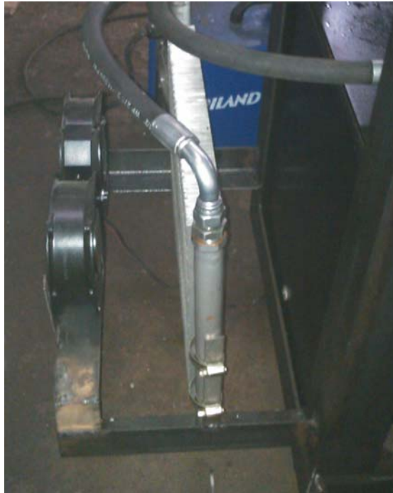
Figura 68. Soporte del intercambiador
