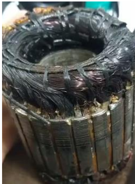
Figura 8. Evidencia de Motores con recalentamiento y falla de bobinado.
