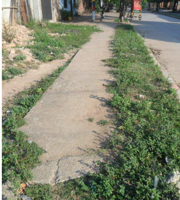
Figura 3. Anden en mal estado
