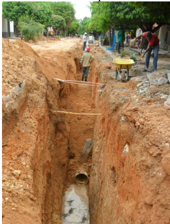
Figura 12. Excavación en zona con presencia de tuberías de gas
