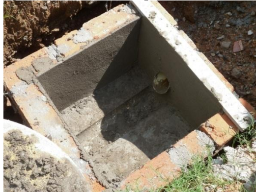
Figura 31. Cámara de inspección de 60*60*60
