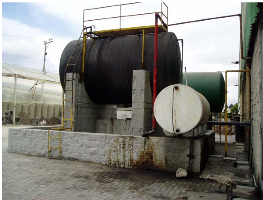
Figura 27. Depósito combustible para caldera
