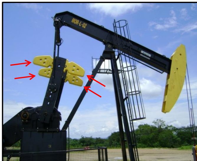
Figura 17. Pesas o Contrapesos de Unidad de Bombeo Mecánico.
