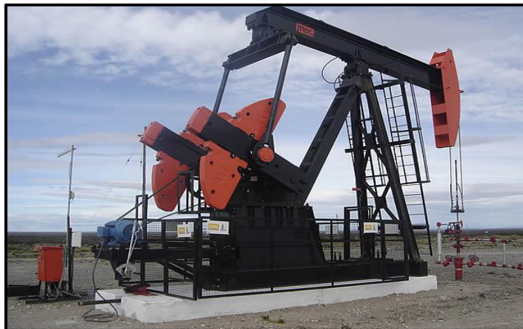
Figura 12. Unidad de Bombeo Mecánico (UBM) Tipo Convencional.
