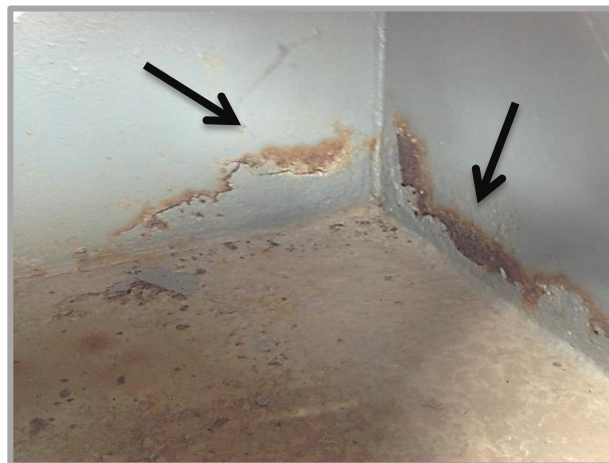
Fotografía 8: Corrosión general por pérdida de recubrimiento En la base No 1 ubicada entre virola 1- cabezal 1.
