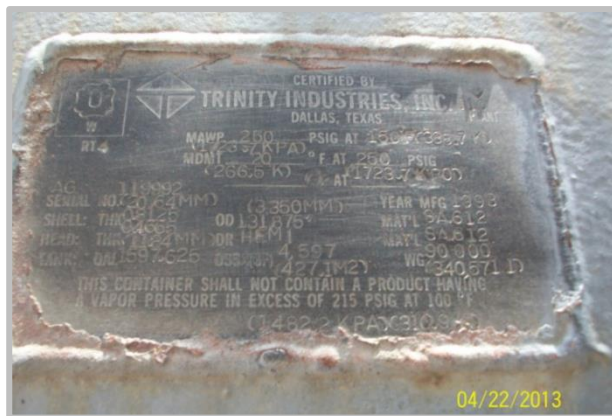
Fotografía 46: Placa de identificación de la bala B-TK-001
