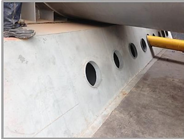
Fotografía 9: Base No 2 ubicada entre virola 17- cabezal 2 Con corrosión general por pérdida de recubrimiento.
