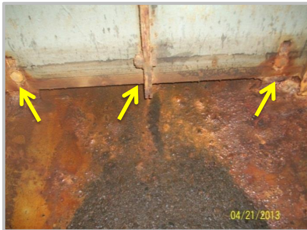
Fotografía 30: Tornillos de anclaje del rompeolas con corrosión.
