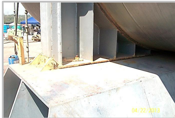
Fotografía 11: Soporte No 2 Con corrosión general por pérdida de recubrimiento.
