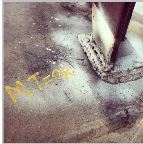
Fotografía 6: Evaluación de las juntas soldadas Entre las platinas de la pasarela y la bala por MT con partículas visibles.
