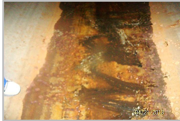
Fotografía 23: Corrosión general en la posición horaria De las 6. Superficie interna de las láminas del cuerpo.
