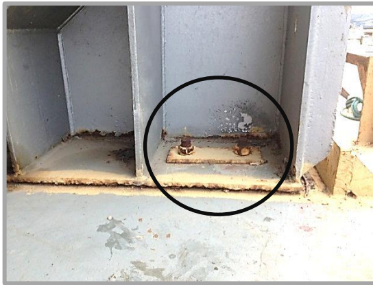
Fotografía 21: Anclajes con principios de corrosión.
