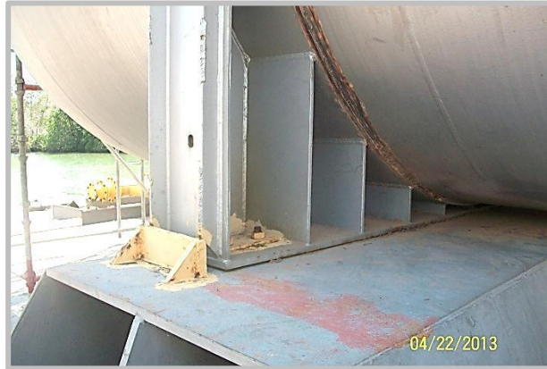
Fotografía 10: Soporte No 1 Con corrosión general por pérdida de recubrimiento.
