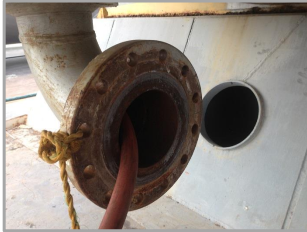
Fotografía 31: Principio de corrosión en brida N4.
