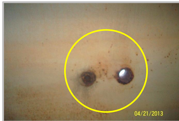
Fotografía 28: Coupling y boquilla con corrosión por Desgaste del recubrimiento superficie Interna del cabezal 1.
