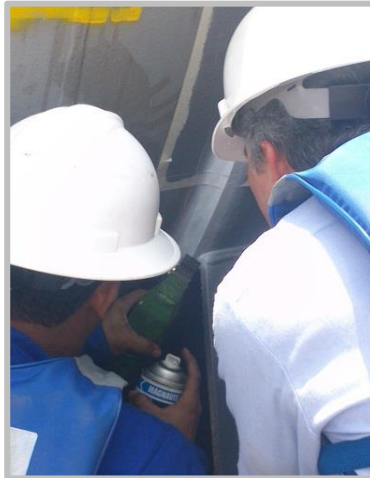
Fotografía 15: Inspección MT de la reparación en la indicación No 1.
