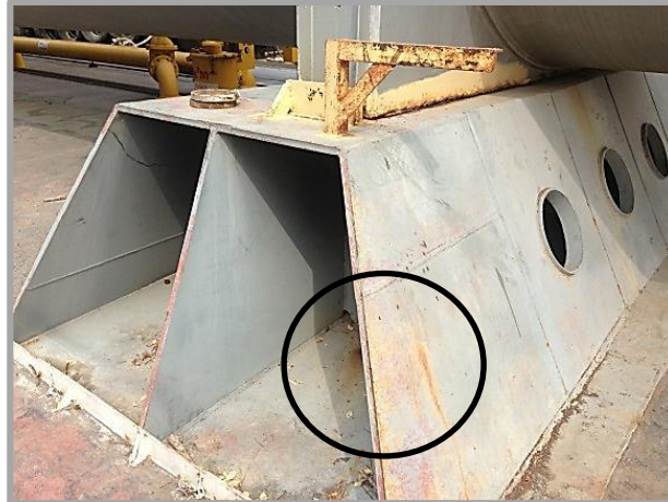
Fotografía 7: Base No 1 ubicada entre virola 1- cabezal 1 Con corrosión general por pérdida de recubrimiento.
