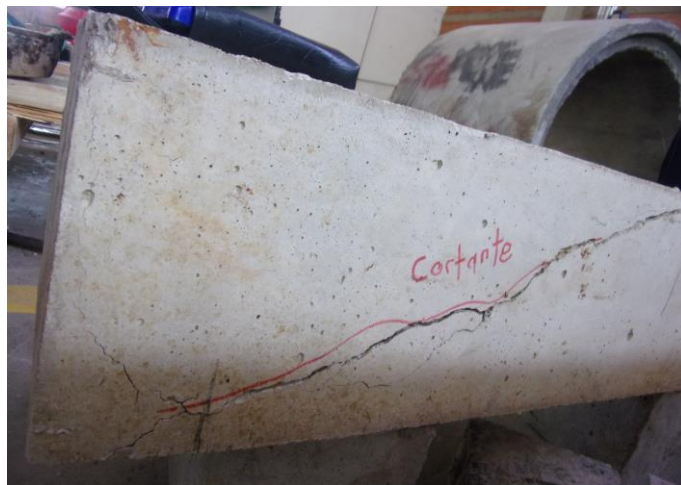
Figura 29. Falla de viga por cortante.
