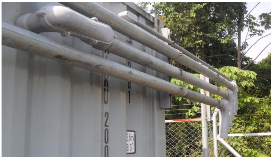
Figura 11. Alimentación a los equipos del skid de compresión.
