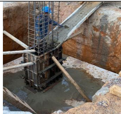
Figura 25 Pedestal en concreto de 3500 psi del eje L – 1 del bloque de aulas.
