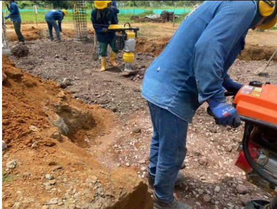
Figura 28 Compactación manual del relleno con material granular a nivel de viga de cimentación del eje M (1 – 2).
