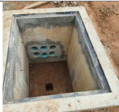
Figura 41 Suministro e instalación de caja CS 276 correspondiente a la remodelación de la red eléctrica de Nivel III
