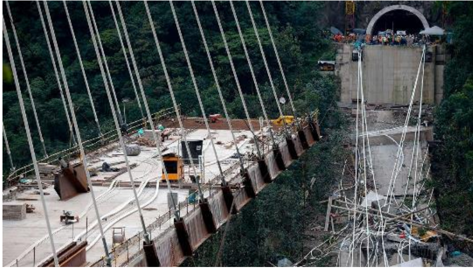
Figura 10. Desplome de puente vehicular en construcción, entre Bogotá y Villavicencio. Colombia. Adaptado de [Fotografía Dirección Nacional de Bomberos de Colombia]. (EEUU, 2018). Archivo fotográfico de CNN Español.
