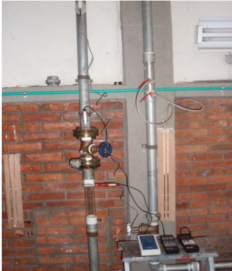
Figura 93. Instrumentación digital en la válvula de prueba
