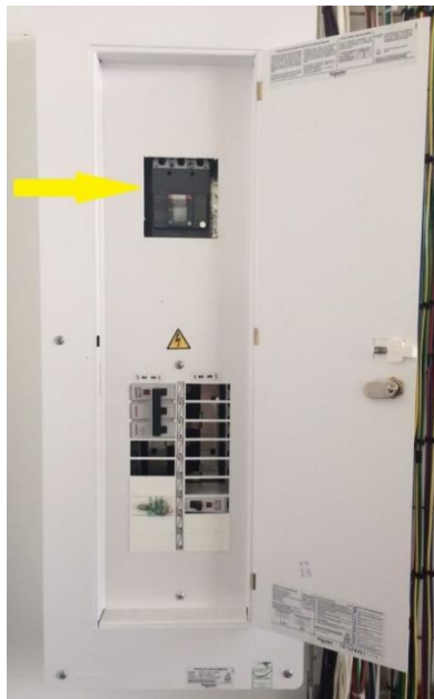
Figura 3. Breaker de protección del circuito ramal desde la fuente Chroma hasta el punto de conexión de la carga.
