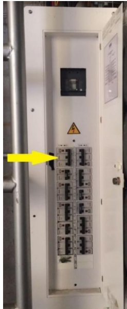
Figura 1. Break del circuito de alimentación de la fuente Chroma en el cuarto técnico.
