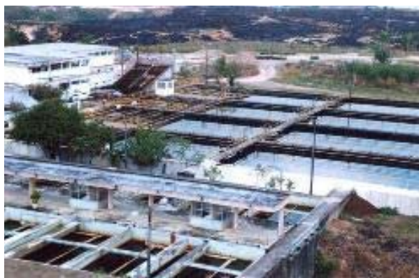
Figura 2. Planta de Tratamiento de Agua de EDASABA E.S.P
