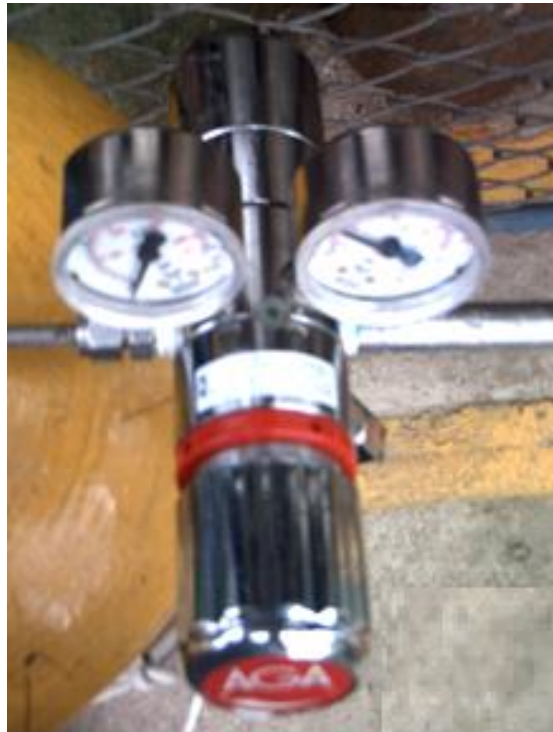
Figura 66. Regulador de dos etapas
