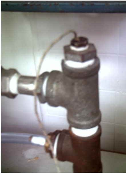
Figura 77. Termocupla para medir la temperatura del gas
