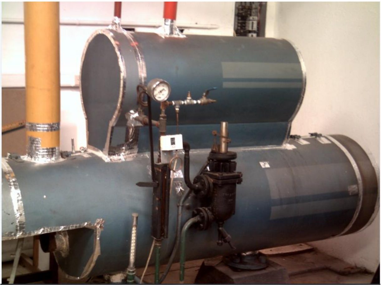
Figura 71. Caldera pirotubular del laboratorio de gases
