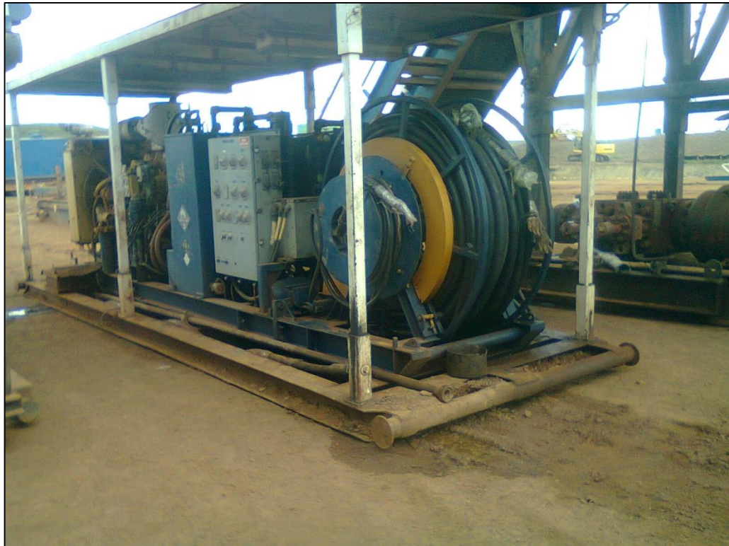
Figura 7. HPU - Unidad hidráulica de poder.
