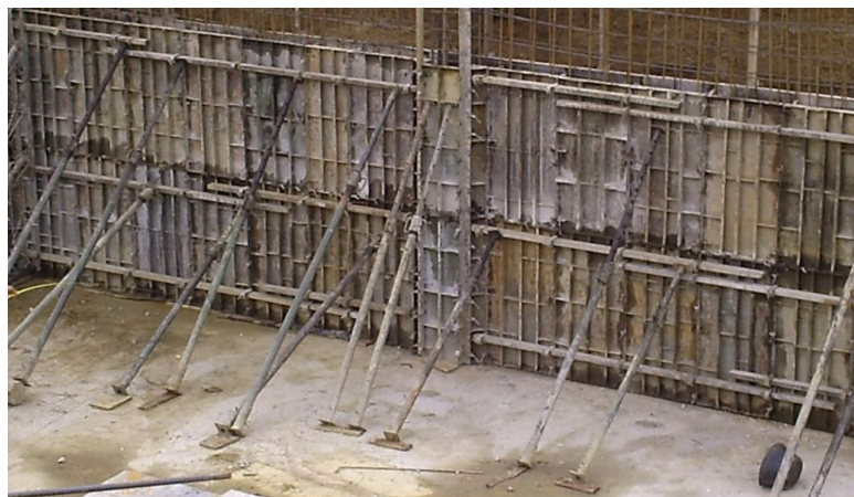
Figura 13: Forma correcta de apuntalar un muro con el paral telescópico
