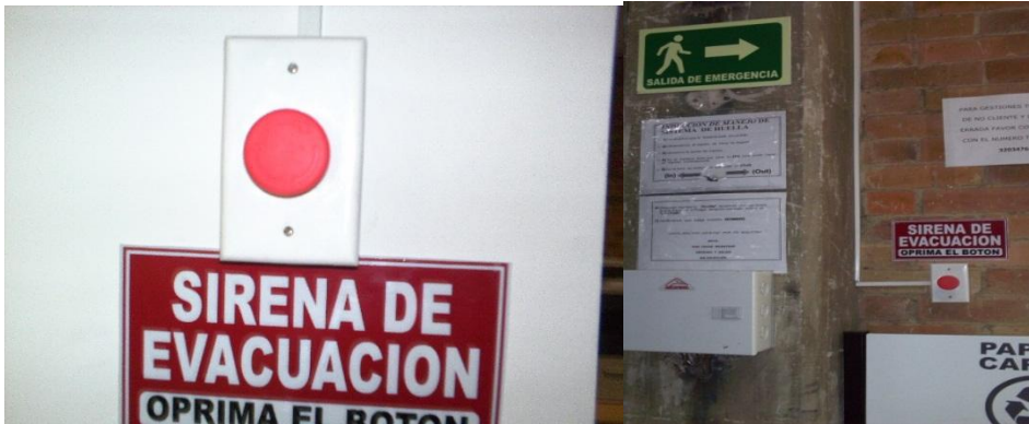
Foto 15 Pulsador de sirena de evacuación
