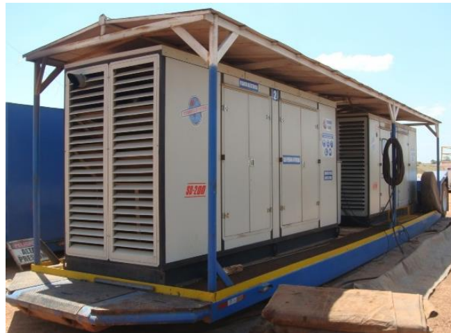
Figura 27. Generadores. Carreño, W.2017.
