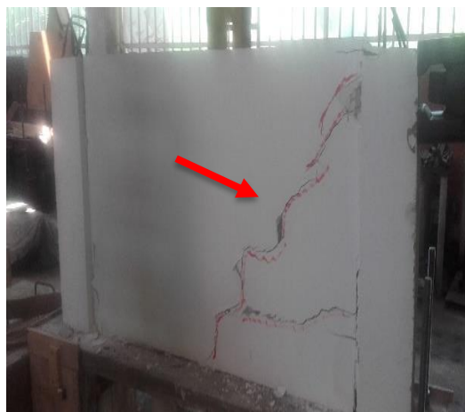
FIGURA 14: Falla por cortante.
