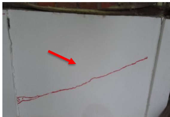
FIGURA 15: Falla por Cortante
