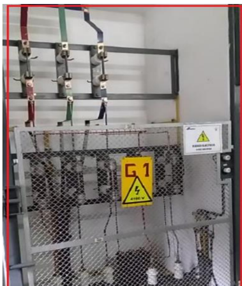
Figura 14. Celdas de media tensión
