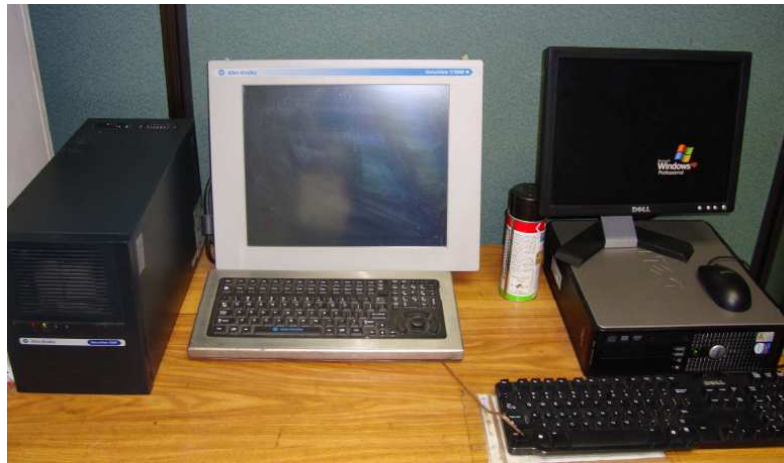
Ilustración 6. Estación de operación FSC
