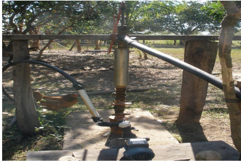
Figura 5. Motobomba para la extracción del agua
