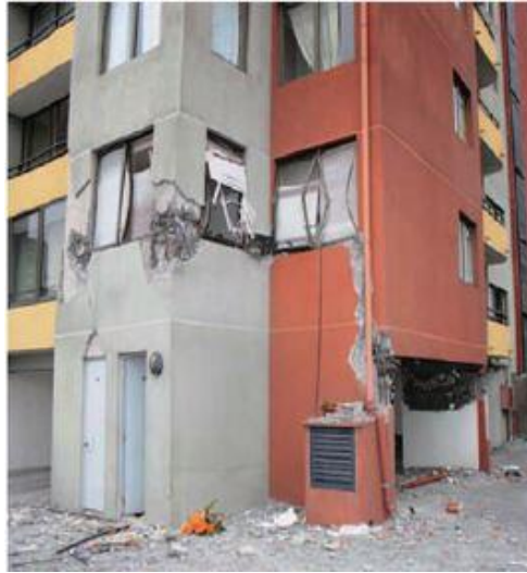
Figura 2. Daño en los primeros pisos de una edificación con muros delgados.
