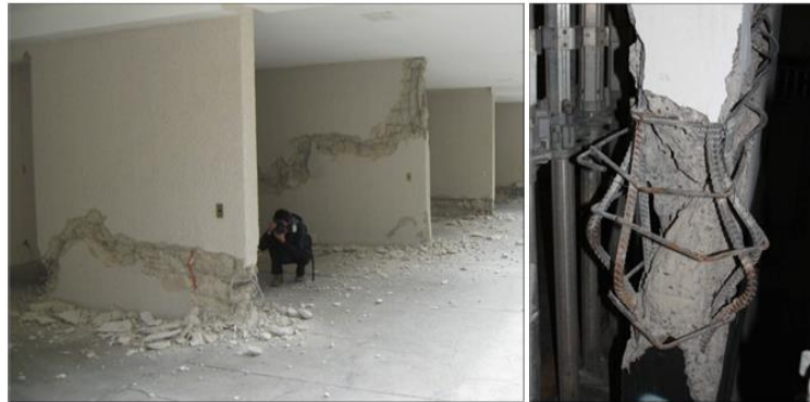
Figura 3. Localización de daño en elementos de borde de muros delgados durante el terremoto de Chile 2010.
