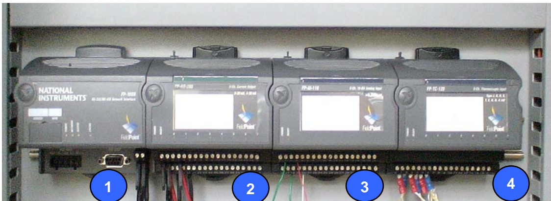
Figura C.2. Fotografía del sistema modular para monitoreo y control FieldPoint
