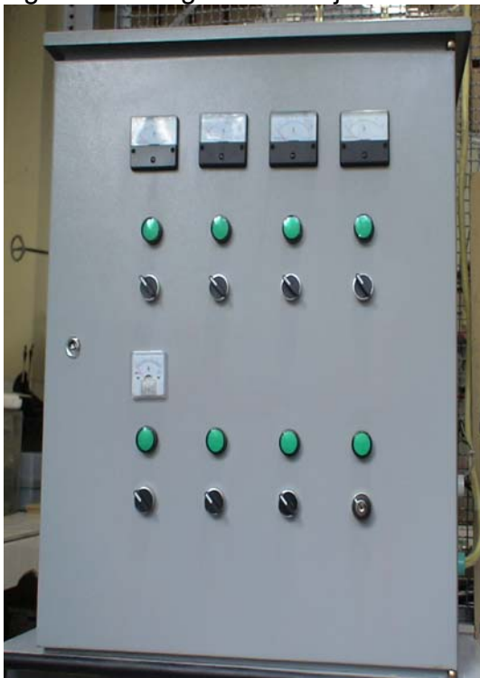
Figura C.4. Fotografía de la caja de control
