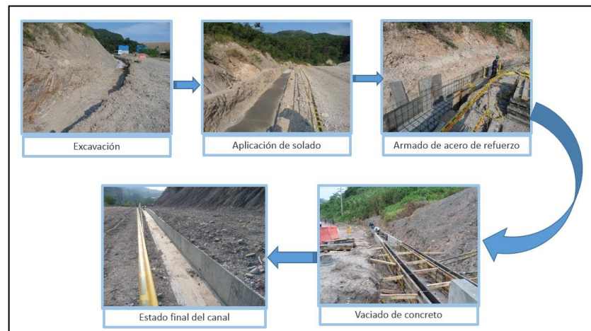
Figura 3. Proceso de construcción de canales para manejo de agua de la vía de acceso a la Central subterránea de Hidrosogamoso.
