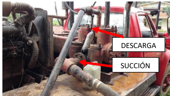
Figura 10. Línea de succión y descarga de una bomba de lodos.
