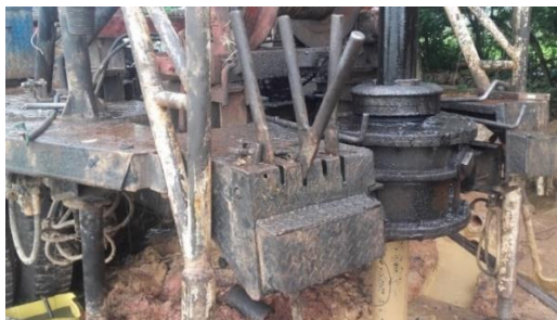
Figura 17. Control de caja de transferencia
