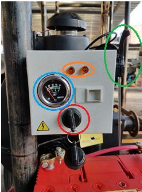
Figura 57. Tablero de mando y control.
