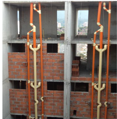
Figura 17: Red sanitaria baños
