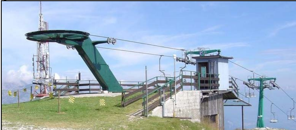
Figura 15. Estación Tensil de Telesilla.
