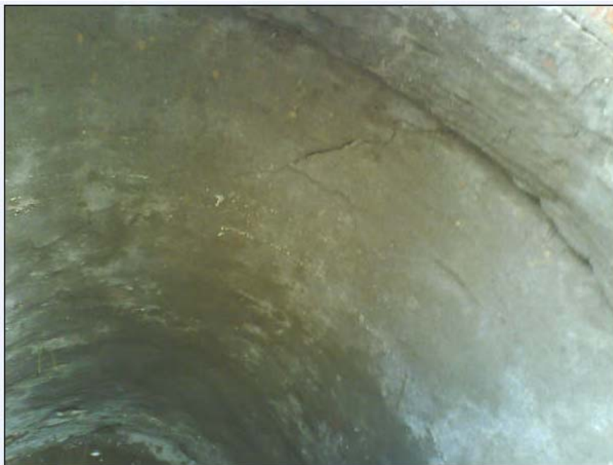
Figura 15. Nuevo? Y con agrietamiento
