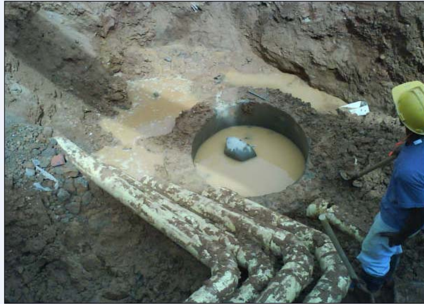
Figura 14. Intemperie de la tubería
