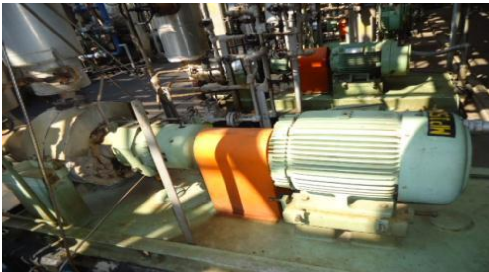
Figura 1. Equipos de Bombeos de la U150
