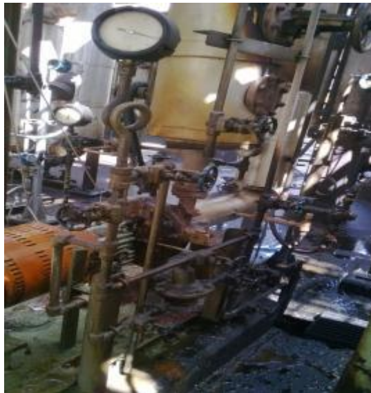
Figura 56. Sistema de vapor al sello del equipo SP156D.
