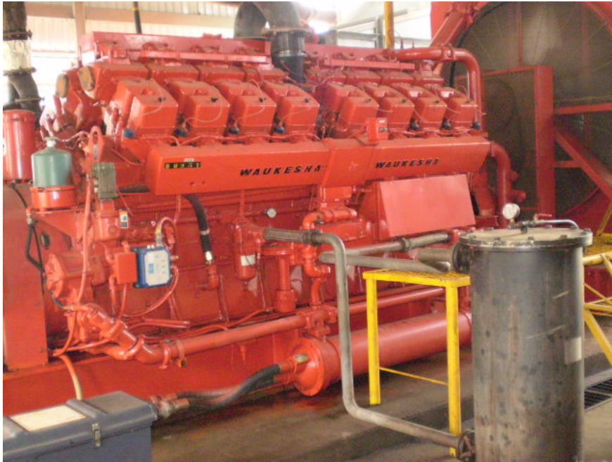
Figura 4. Moto-generador Waukesha P9390G
