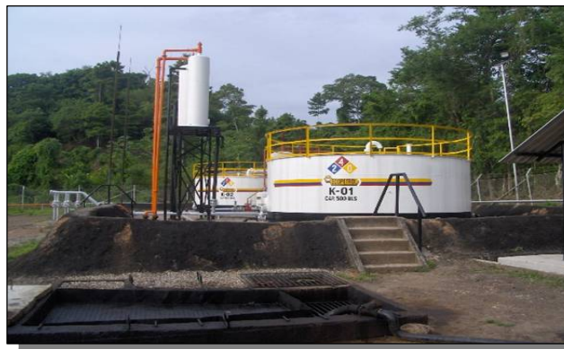
Fotografía 1. Batería de recolección 4
