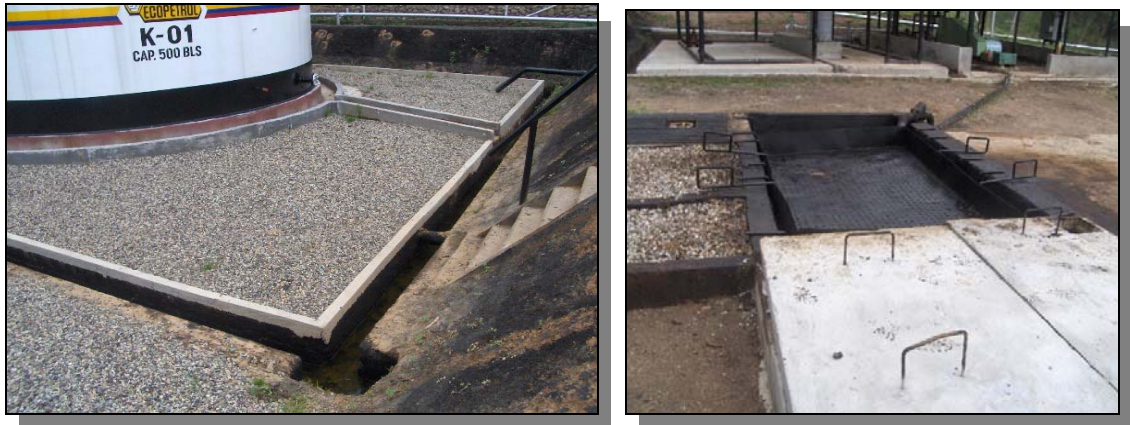
Fotografía 4. Sistema de recolección de aguas lluvias y Caja recolectora de aguas aceitosas
