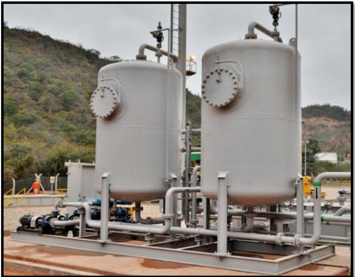
Figura 35. Vista exterior de filtros pulidor
