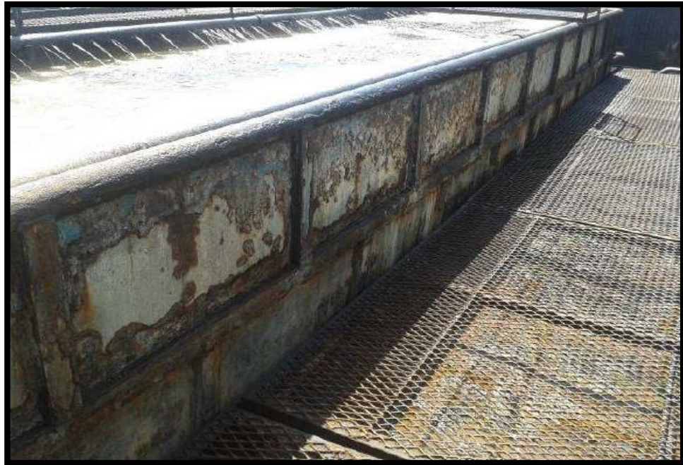
Figura 13. Deterioro de los catch tank del campo
