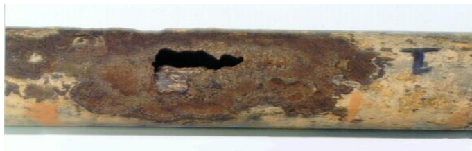
Figura 9. Pérdida total de una tubería por acción corrosiva
