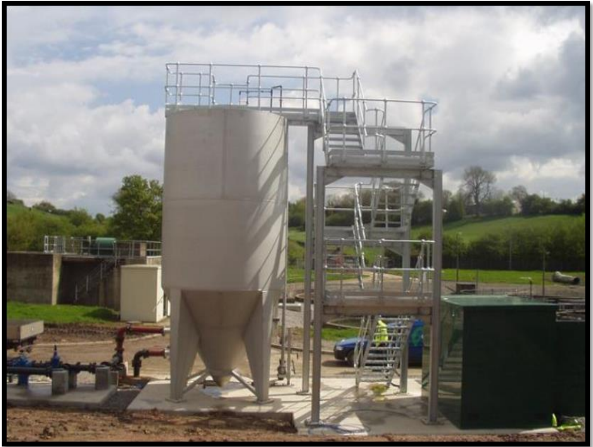
Figura 34. Vista exterior de un filtro multilecho
