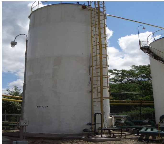
Figura 63. Tanque de almacenamiento (Skimmer tank)
