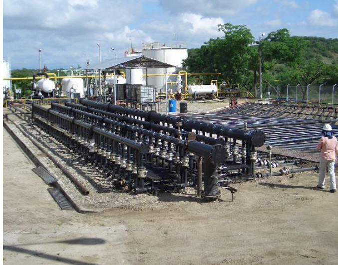
Figura 65. Manifold de la Batería Tello.
