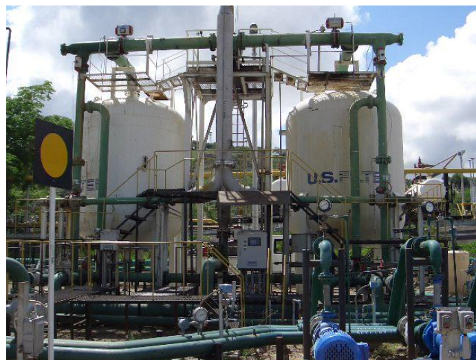
Figura 66. Filtros de agua tipo cáscara de Nuez
