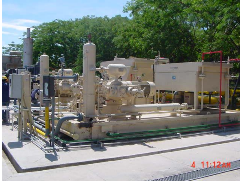
Figura 69. Compresor Ariel JGP-1
