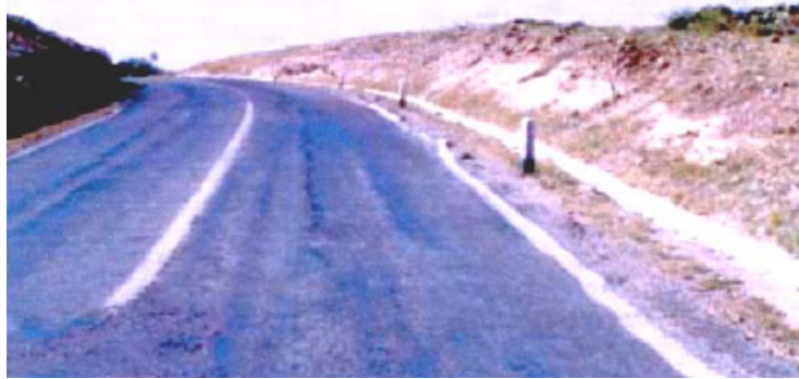
FIGURA 1 Deformaciones plásticas en la vía
