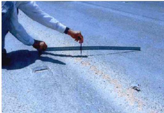
FIGURA 2 Deformación permanente en pavimentos
