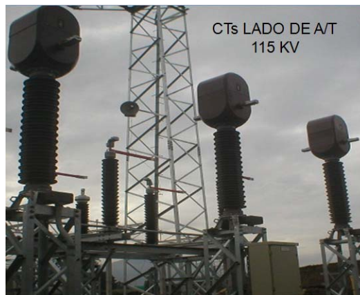
Ilustración 43. Transformadores de corriente 115kV
