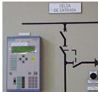
Ilustración 48. Panel de control 34,5kV
