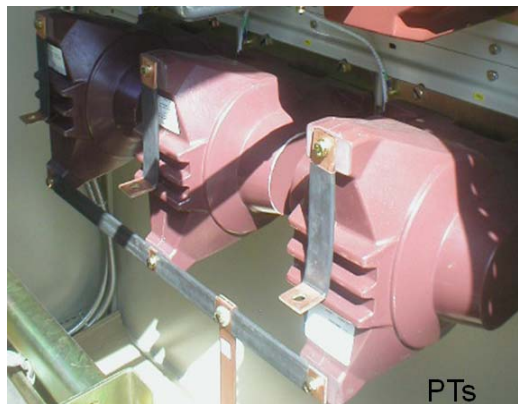
Ilustración 51. Transformadores de potencial 34,5kV.
