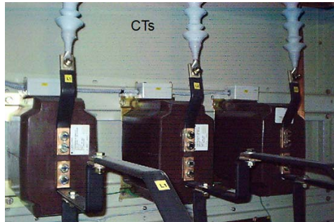
Ilustración 50. Transformadores de corriente 34,5kV
