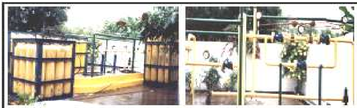
Figura 8. Estación De Almacenamiento Y Descompresión De Gas Natural Comprimido.
