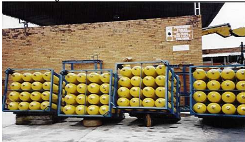
Figura 5. Baterías de almacenamiento de GNC
