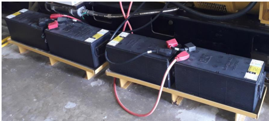
Baterías Generador XQ1750
