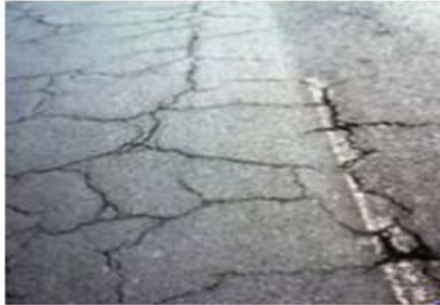
Figura 53. Falla por fatiga del pavimento. Adaptado de Tipos de deterioros en Pavimentos de Concreto” (2017). Catalogo ARGOS, Disponible en: www.argos.com.co .
