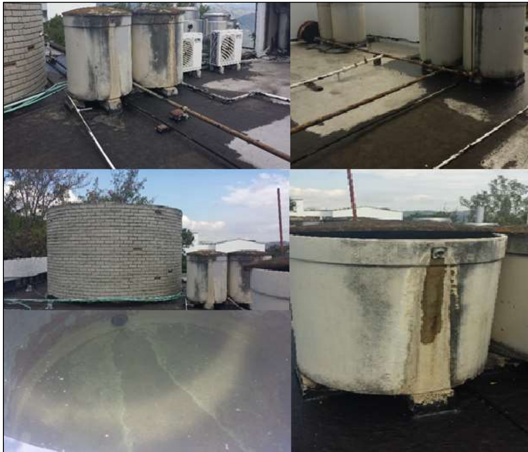
Figura 17. Evidencia estado actual tanques Sección Comedores y Cafetería
