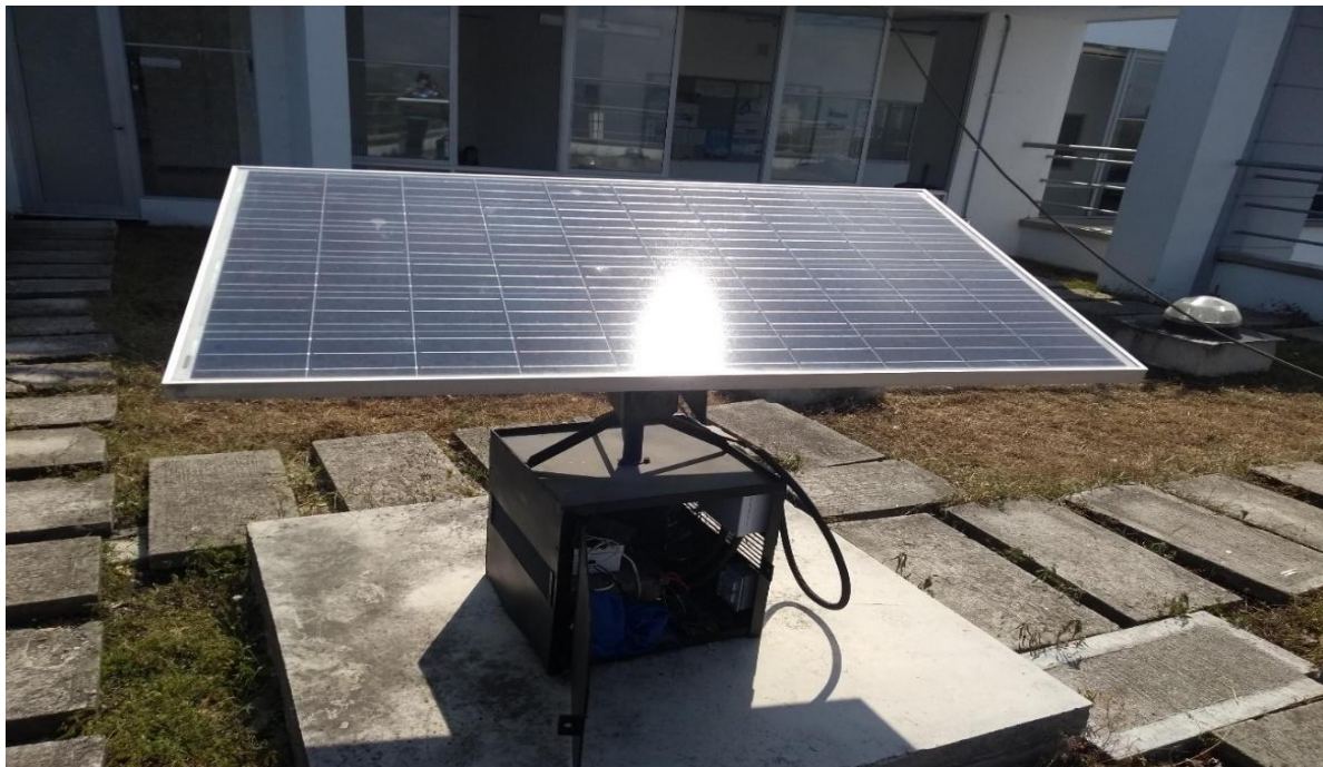
Figura 3. Seguidos solar del Edificio de Ingeniería Eléctrica.
