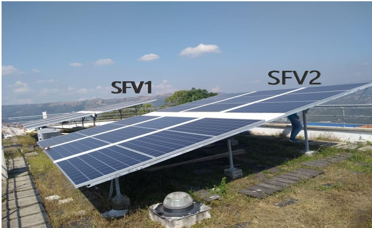
Figura 2. SFV1 y SFV2 del Edificio de Ingeniería Eléctrica.
