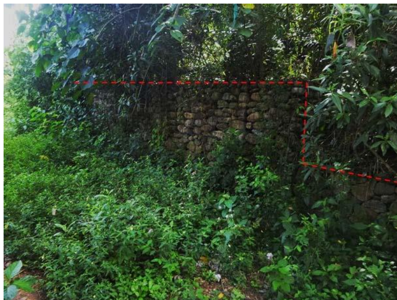
Figura 27. Indicios de movimiento del sector, presencia de muro de gaviones.
