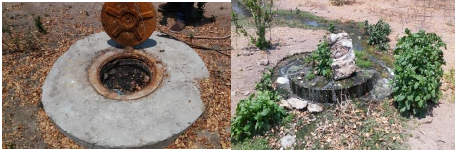
Figura 10. Pozos de inspección rebosados por acumulación de residuos sólidos.
