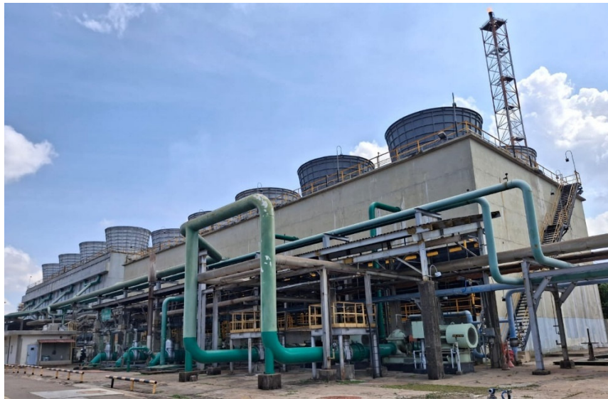
Figura 2. Torre de Enfriamiento de la GRB
