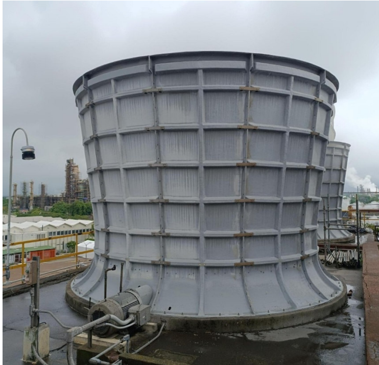
Figura 3. Cono de Ventilador en una Torre de Enfriamiento
