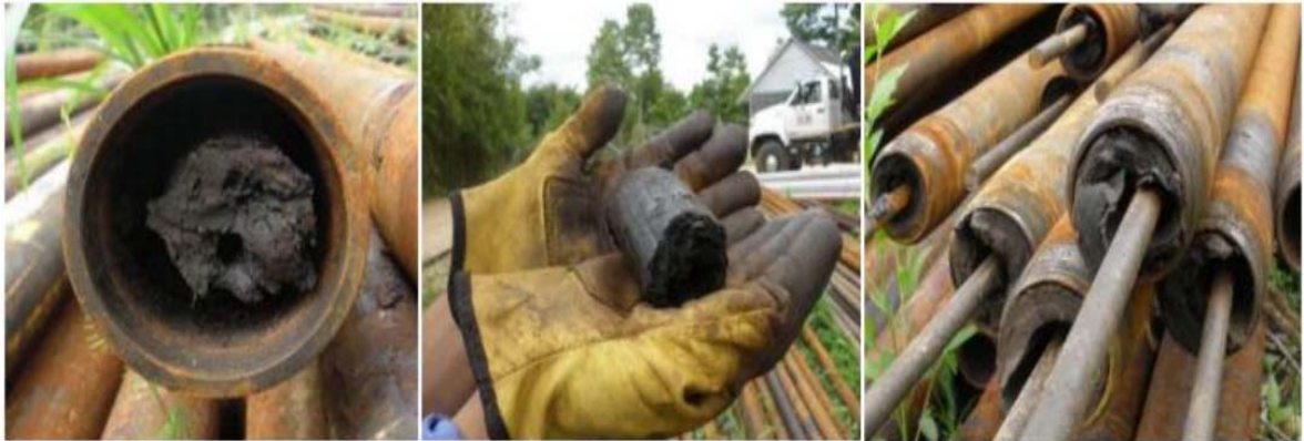
Figura 4. Parafinas depositadas en tuberías de producción del Campo Colorado 20
