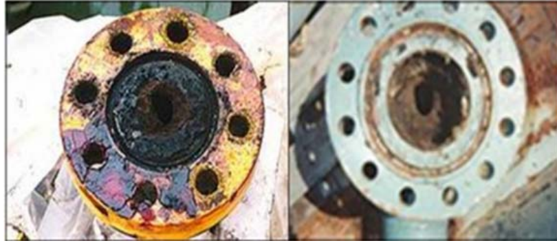
Figura 5. Obstrucción de tuberías por precipitación de parafinas 27
