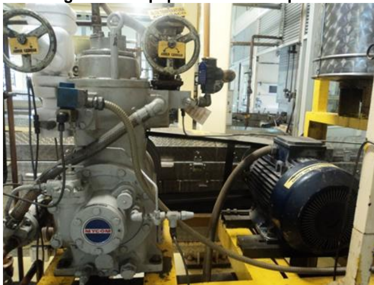
Figura 20. Fotografía de equipo crítico: Compresor de amoniaco
