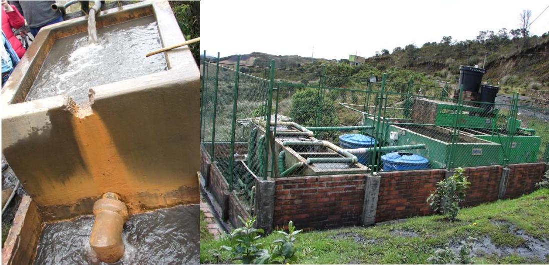
Figura 2. Sistema de tratamiento convencional de drenajes ácidos de mina. Mina San Cristóbal (zona rural de Zipaquirá en Cundinamarca).
