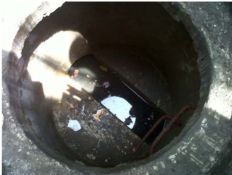
Foto 14. Pozos tapados en el barrio Villa Candado
