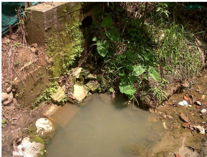
Foto 9. Entrega de aguas lluvias Urbanización Ronda III y IV en la quebrada La Clausen.
