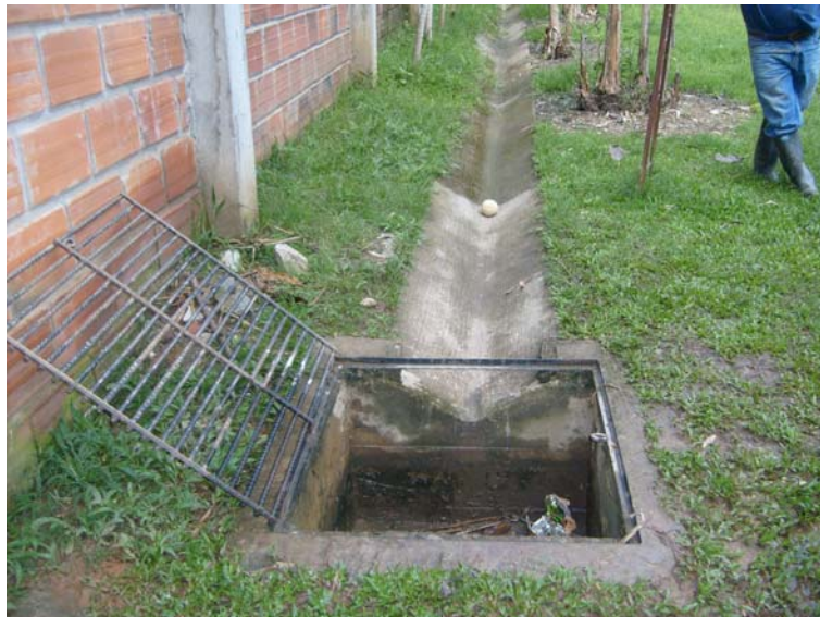
Foto 21. Canaleta conectada al pozo de aguas negras
