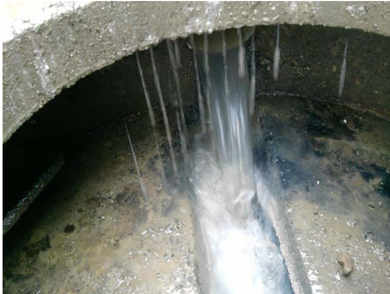
Foto 20. Caudal aportado por el barrio Manantial al pozo de Piedra del Sol.
