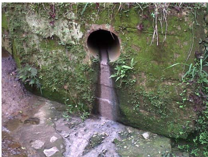
Foto 10. Entrega de aguas lluvias Urbanización Ronda III y IV en la quebrada Puente Loco.
