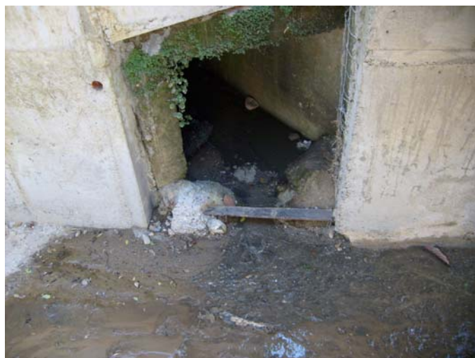
Foto 8. Contaminación de la entrega de aguas lluvias del barrio Santa Helena de la Sierra I etapa.
