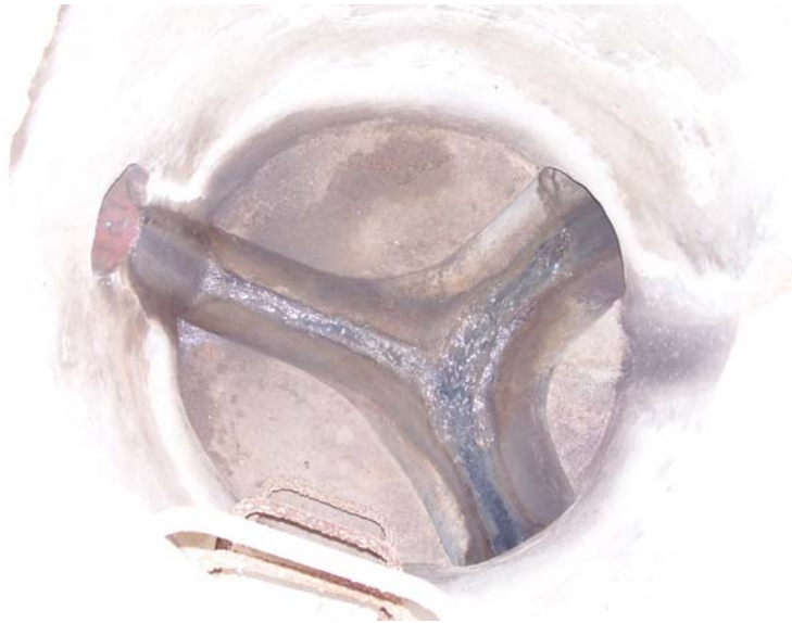
Foto 6. Pozo de aguas lluvias contaminado Urbanización La Riviera
