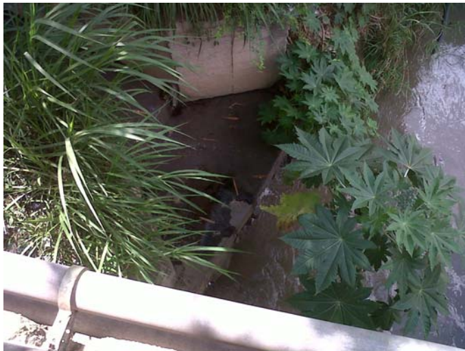
Foto 12. Contaminación de la entrega de aguas lluvias Urbanización San Jorge II.
