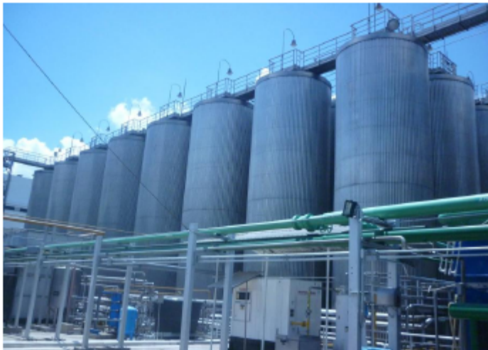
Tanques (fermentación – Maduración)
