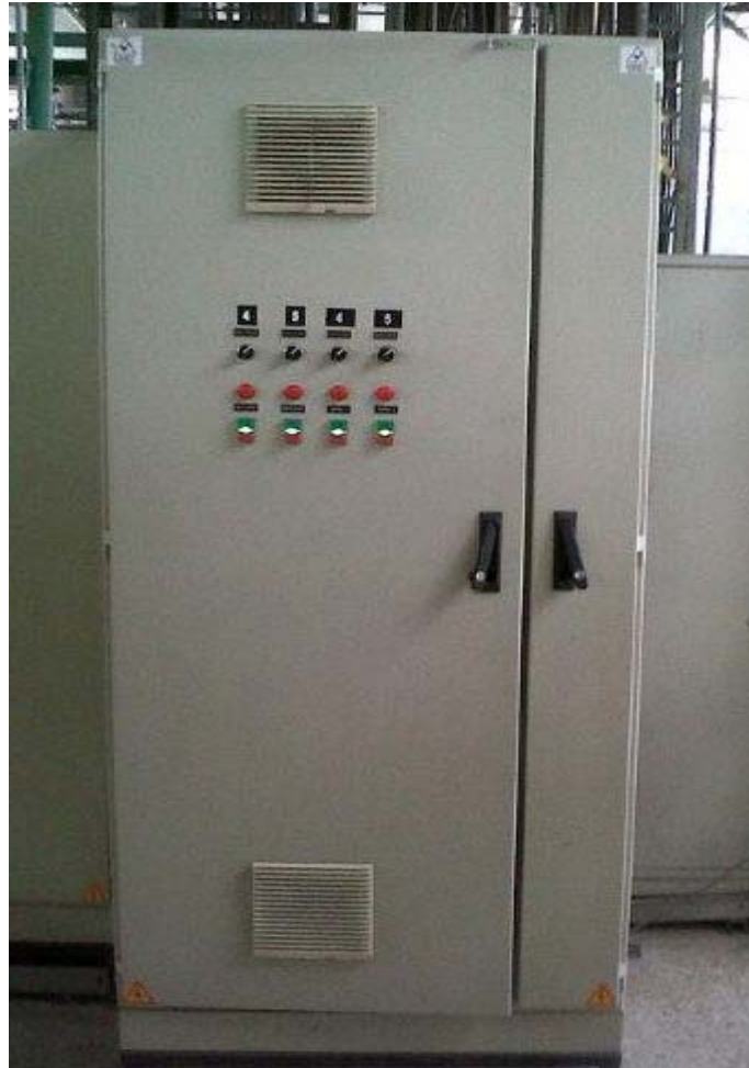
Figura 14. Tablero eléctrico suministrado por la cervecería para el montaje.[Tomada en la cervecería Bavaria de Bucaramanga por autores]
