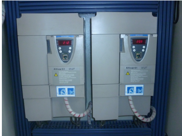
Figura 15. Variadores de velocidad instalados en el tablero eléctrico.
