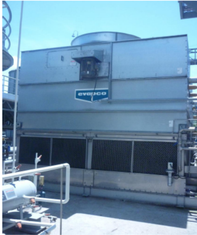
Condensador evaporativo CATC-367 en la cervecera de Bucaramanga.
