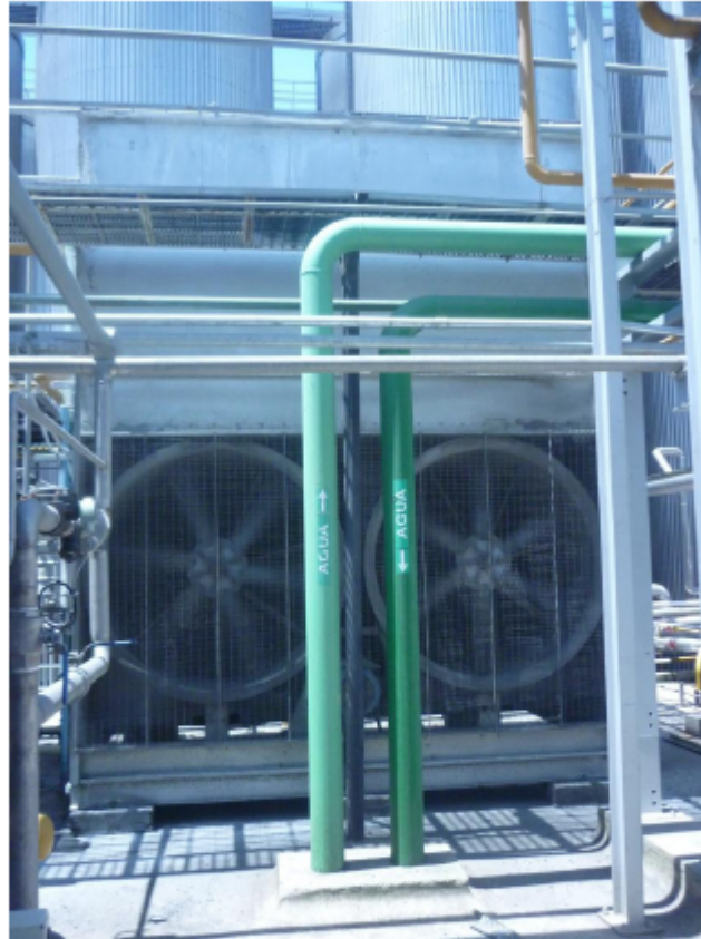
Condensador evaporativo PMCA 475 en la cervecera de Bucaramanga.
