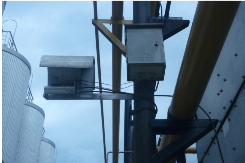
Figura 10. Transmisor de temperatura de bulbo húmedo.[Tomada por los autores]
