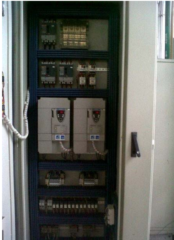
Figura 22. Tablero eléctrico con los variadores de frecuencia y las protecciones instalados.
